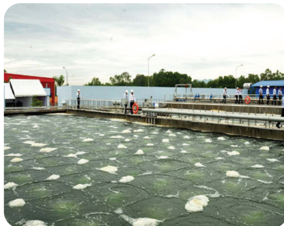
Hình 6.8. Nhà máy xử lý nước thải KCN VSIP Quảng Ngãi (xã Tịnh Phong, huyện Sơn Tịnh)
