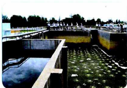
Hình 7.6. Nhà máy xử lý nước thải VSIP ở tỉnh Quảng Ngãi
